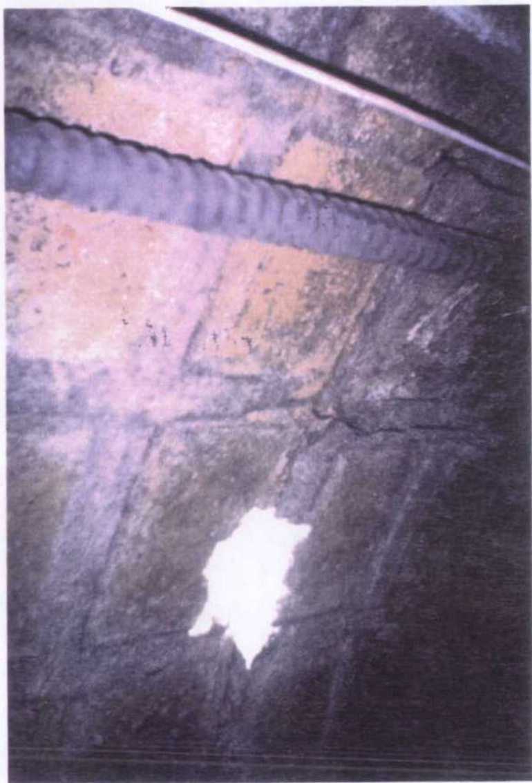
Foto 11.- Grietas y testigos en Pozo "Alicia" de COFASA.
