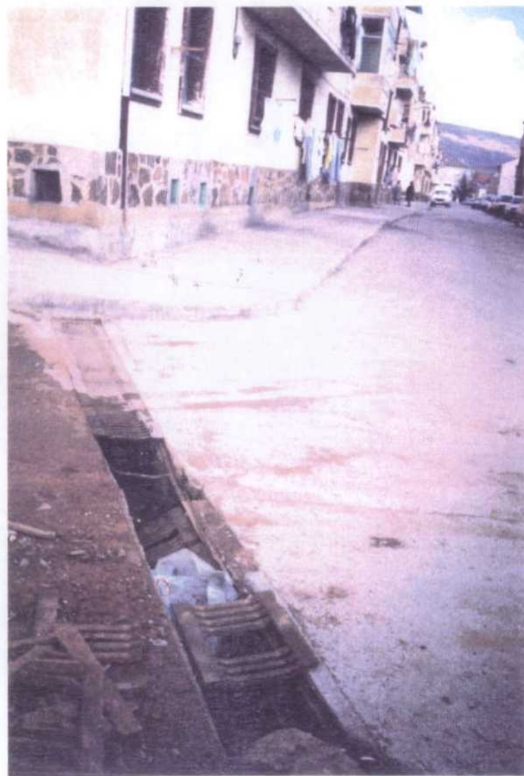
Foto 6.- Zanja de recogida de aguas pluviales deteriorada.
