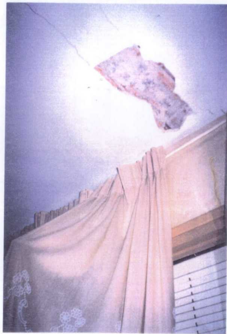
Foto 4.- Desprendimiento de partículas.
