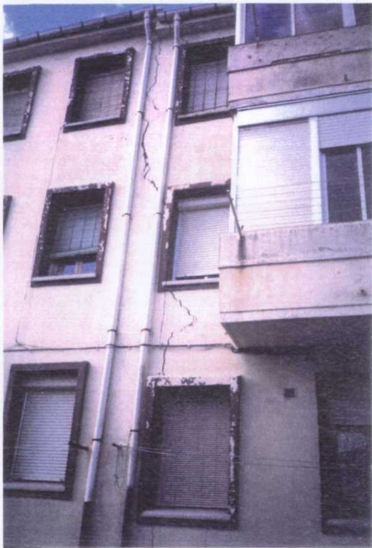
Foto 1.- Edificio de la C/ Generalísimo con grietas importantes en la fachada.
