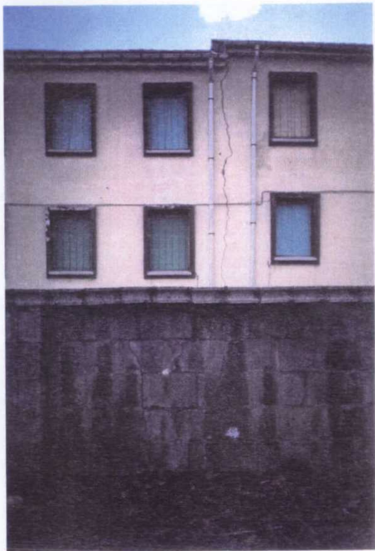
Foto 9.- Continuidad de agrietamientos en la cerca del I.F.P. de Fabero y edificios.
