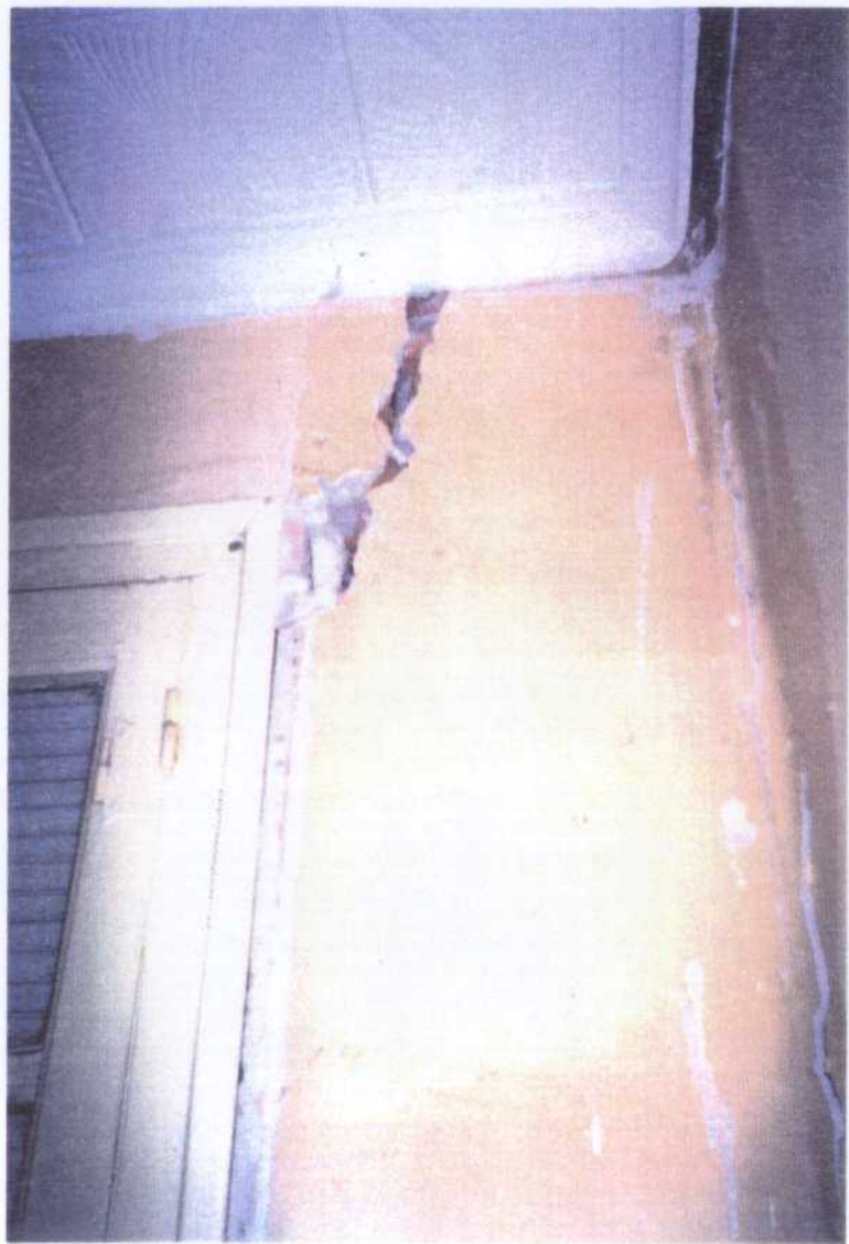
Foto 7.- Vivienda en la C/ Generalísimo con marcos desencajados y grietas que comunican con el exterior.
