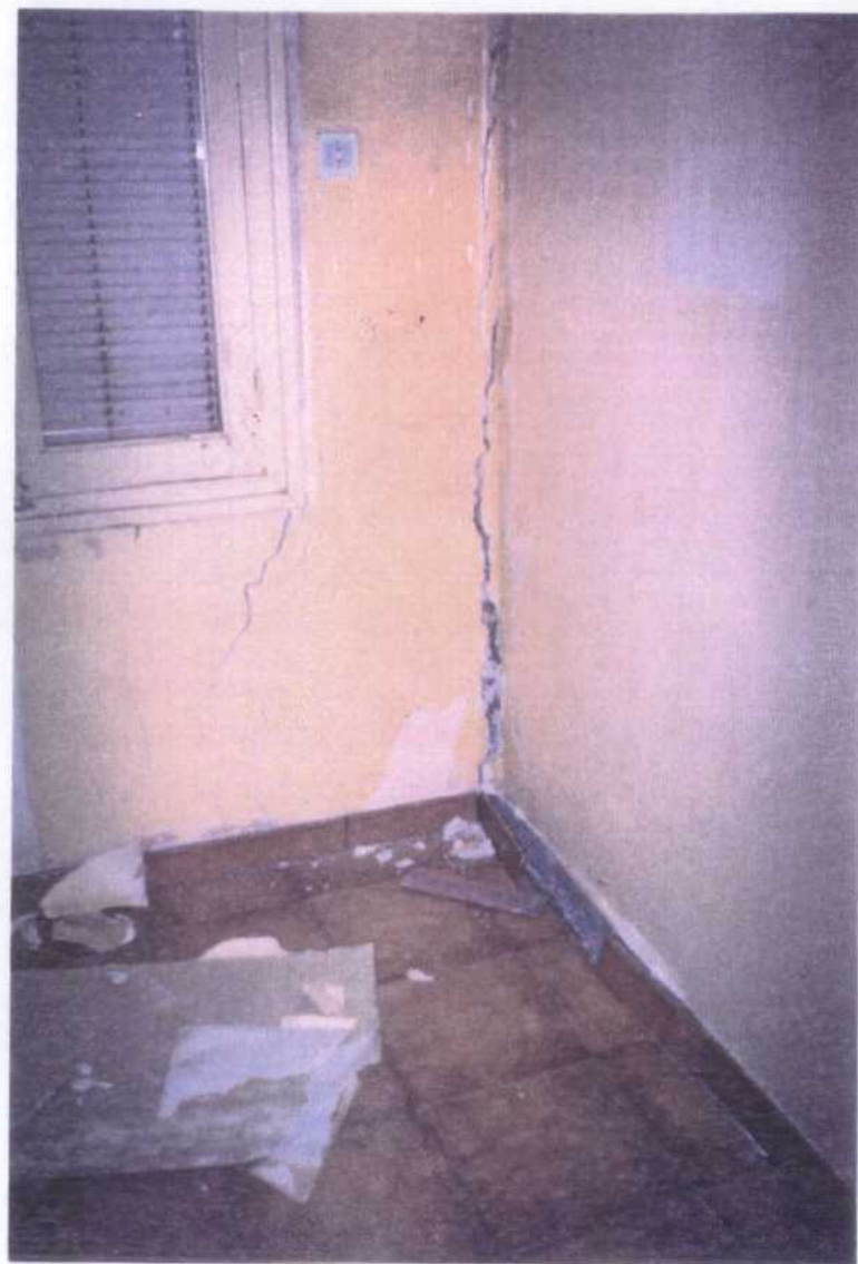
Foto 2.- Grietas de tracción en vivienda de la C/ Generalísimo.
