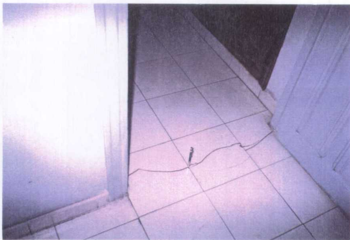
Foto 14.- Agrietamiento en el piso del edificio Oficinas de COFASA.
