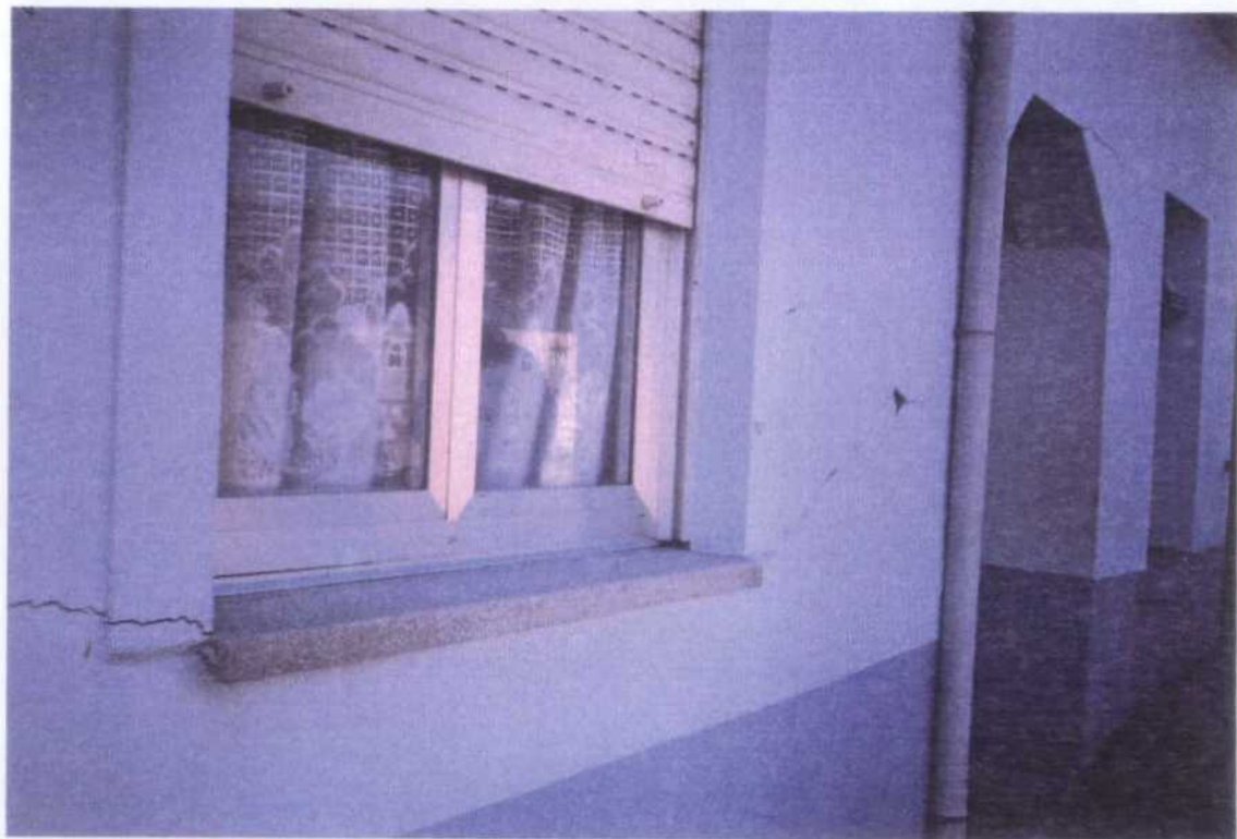
Foto 10.- Grietas horizontales en fachada de la C/ Calzada sin apenas separación entre labios.
